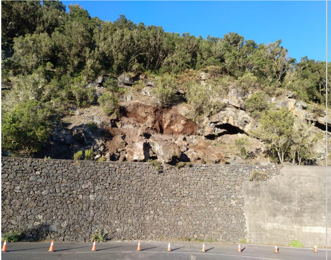
Fotografía n.º 4: Frente del desprendimiento y vía HI-1
