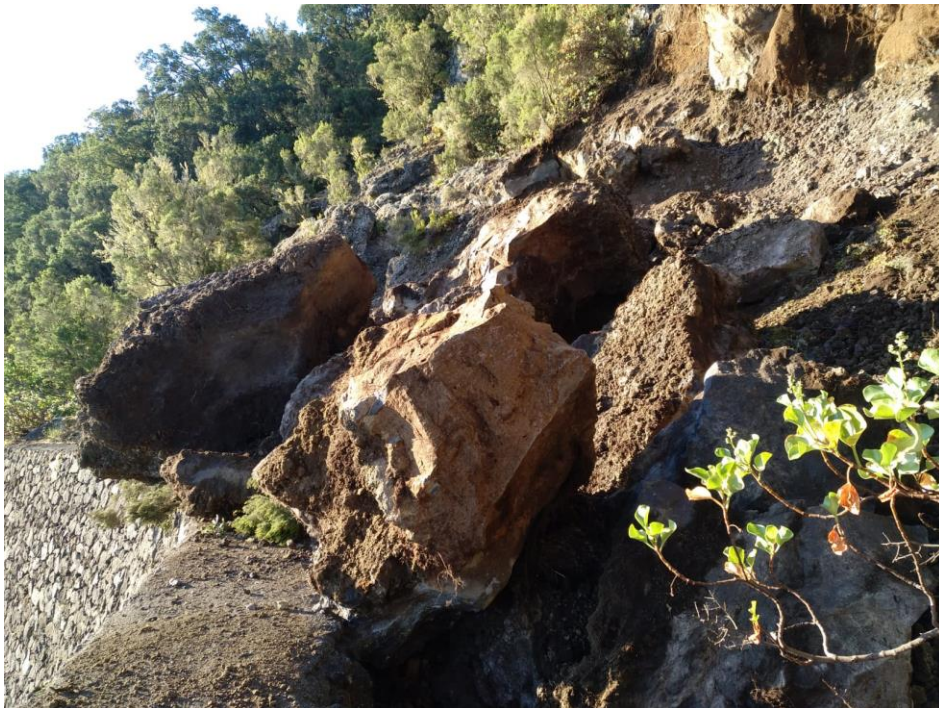
Fotografía n.º 3: Bloques descalzados por el desprendimiento apoyados en la coronación del muro
