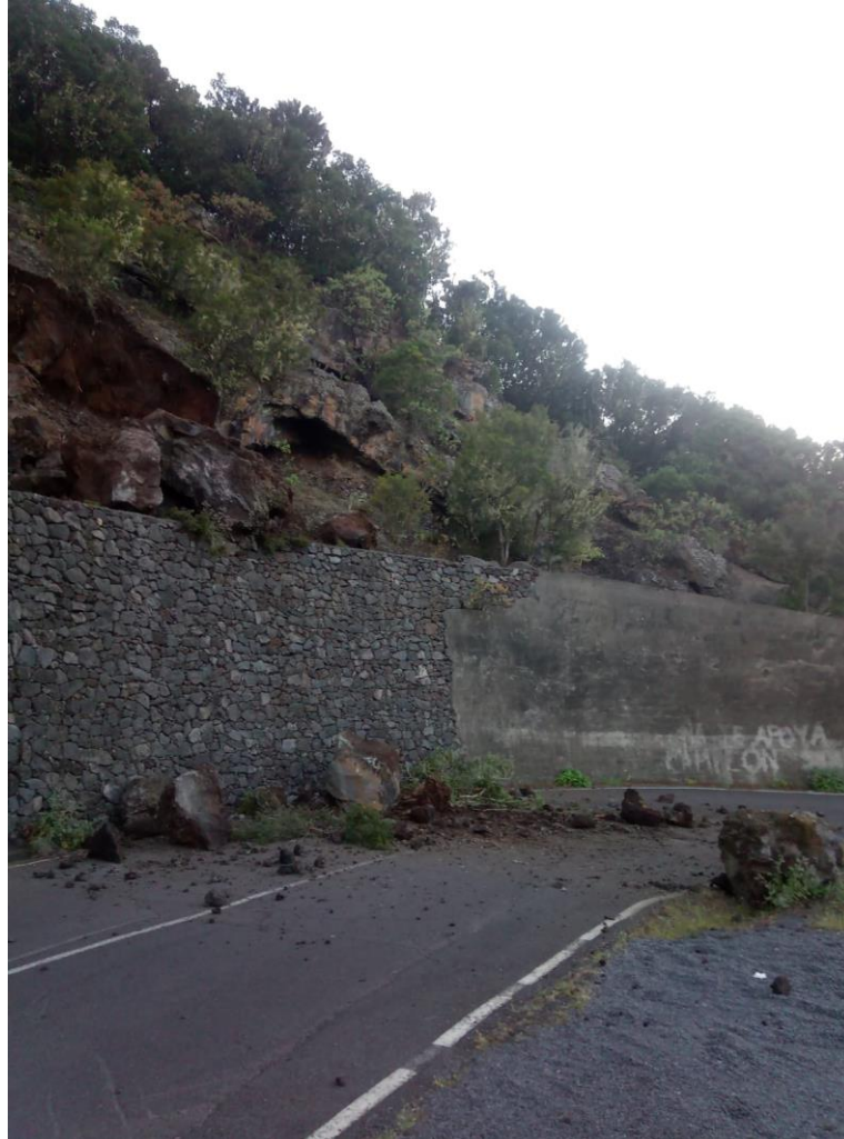
Fotografía n.º 1: Vista general del desprendimiento sobre la vía HI-1, P.K 21+200 al PK 21+280
